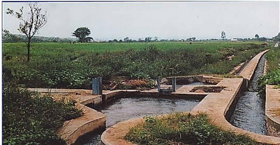
Gambar 5. Bangunan bagi dan sadap
