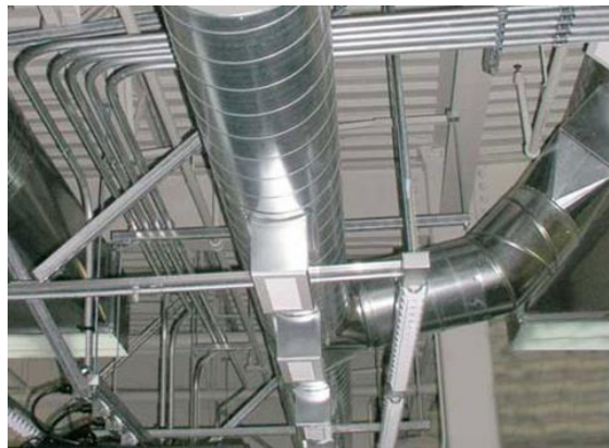
Gambar 1 Penggunaan Ducting System di Industri
