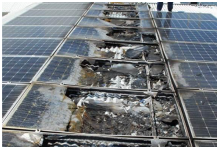
Modul surya dalam keadaan terbakar
