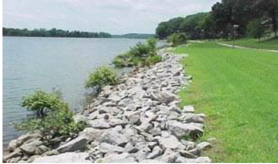
Gambar 3.11 Batu–batu kasar yang ditempatkan di pinggir pantai untuk mengurangi erosi air laut
