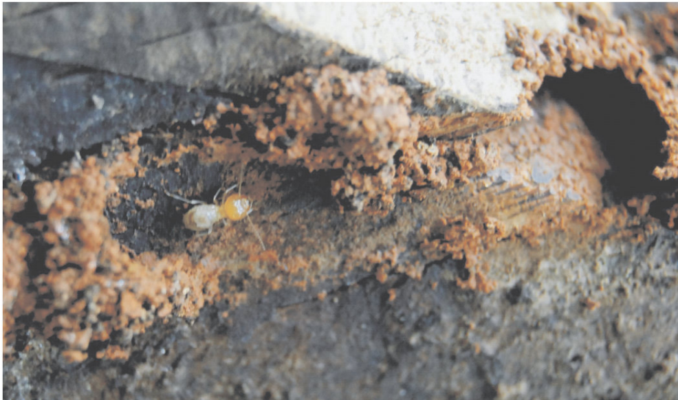
Gambar 24. Liang kembara rayap tanah pada permukaan batang kelapa sawit
