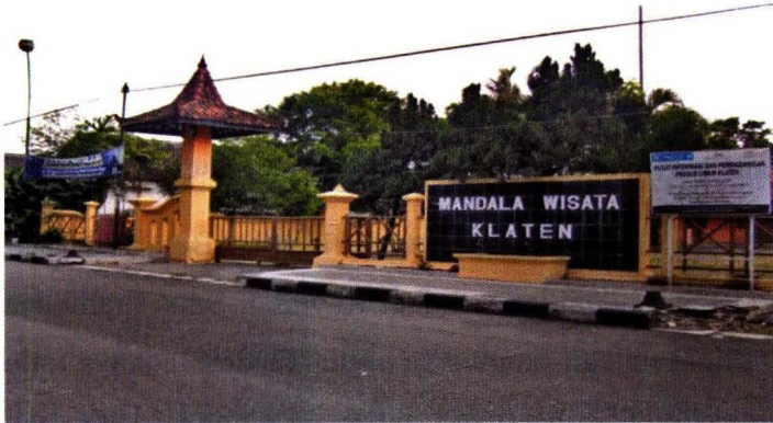
Foto 24. Gedung Mandala Wisata Yang Tidak Terawat
