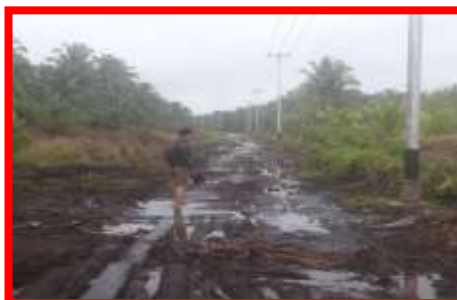
Kondisi jalan becek, hancur, berlumpur saat hujan
