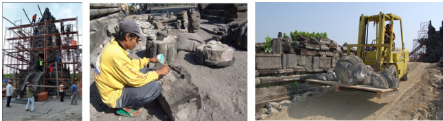
Gambar 2.9 Kegiatan penyelamatan pada Cagar Budaya yang dilakukan pasca bencana gempa bumi DIY dan Jawa Tengah Tahun 2006 (Sumber: BPCB Jawa Tengah)
