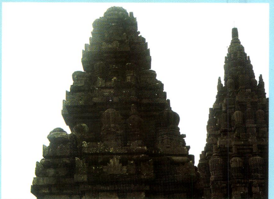
Ratna atap Candi Apit Utara yang mengalami pergeseran dan keruntuhan
