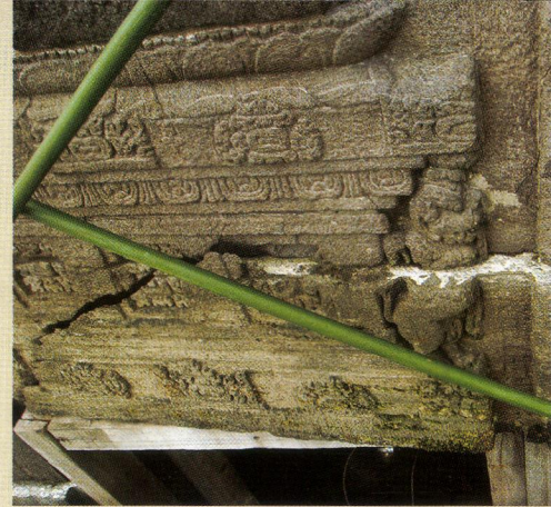
Kerusakan struktural dan material pada ambang pintu masuk bilik barat
