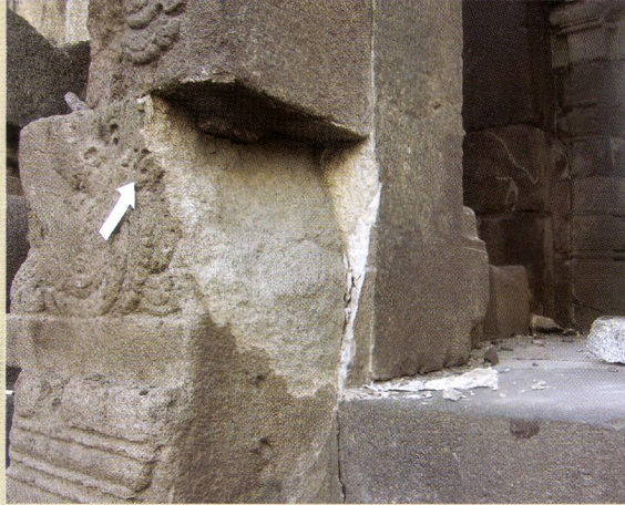
Kerusakan struktural dan material pada pintu masuk bilik barat
