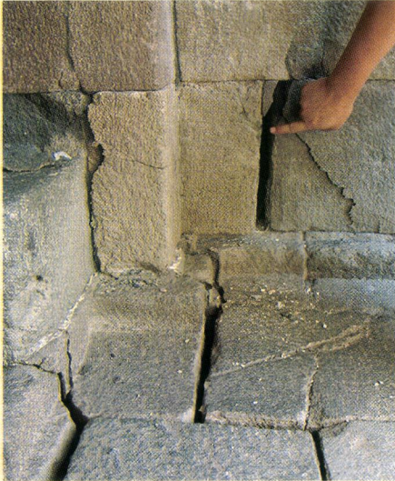
Kerusakan struktural pada dinding dan lantai selasar
