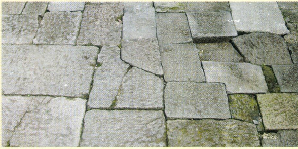
Kondisi batu lantai sebelum dilakukan rehabilitasi
