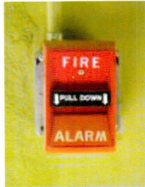
Gambar 20. Alarm Peringatan Kebakaran
