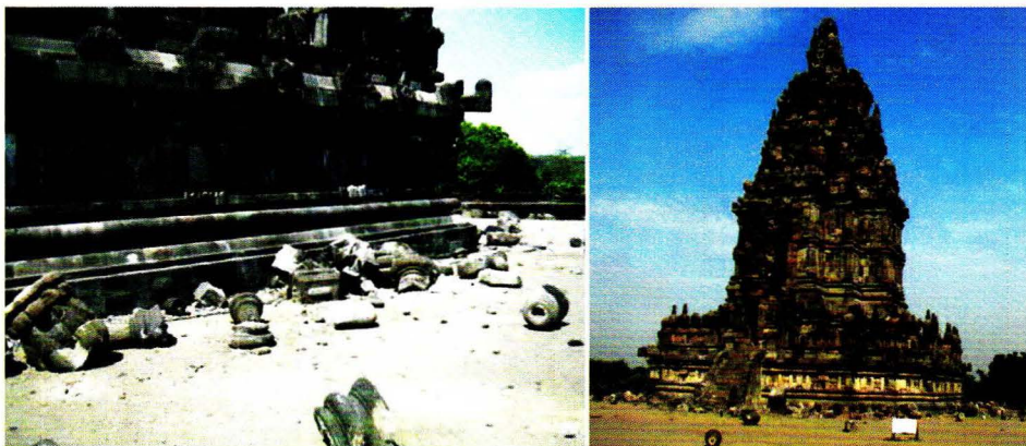
Gambar 15. Kerusakan bangunan Candi Prambanan akibat gempabumi tektonik DIY dan Jateng tahun 2006 (Foto: BPCB Jawa Tengah)
