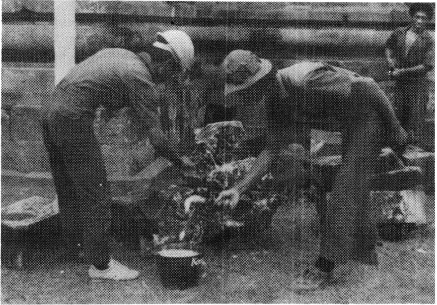
Pengolesan bahan kimia AC 322 pada permukaan jamur kerak yang tumbuh di batu.
