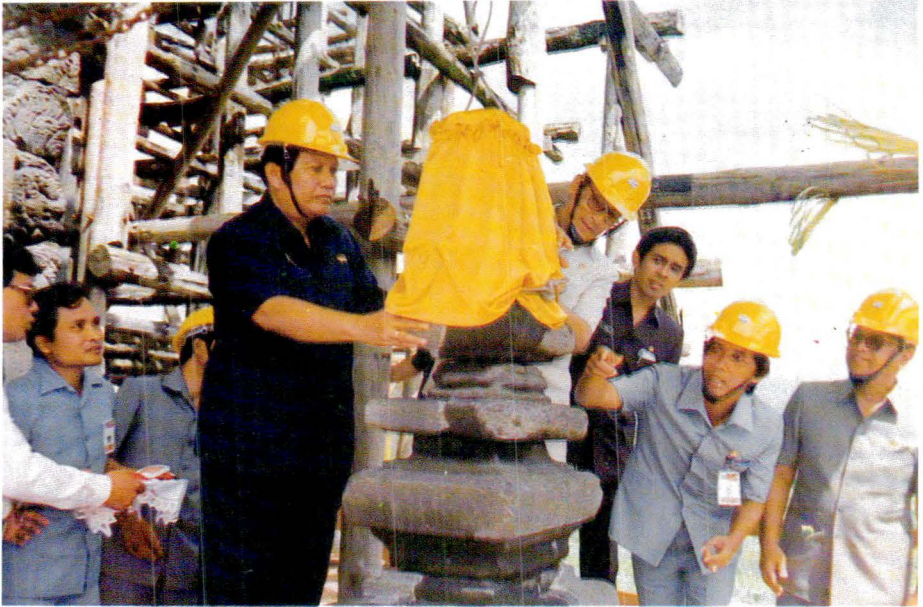
Peletakan batu terakhir candi Wisnu oleh Menteri Pendidikan dan Kebudayaan yang didampingi Menteri Pariwisata Pos dan Telekomunikasi pada tanggal 18 Januari 1991.
