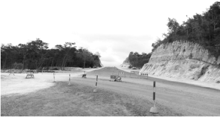
Kondisi jalan JLS Dusun Semampir, Desa Semugih, Kecamatan Rongkop. (foto dokumentasi pribadi)
