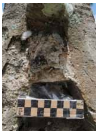
Foto 4. Bagian ornament waruga yang mengalami pelapukan dan terkelupas .
