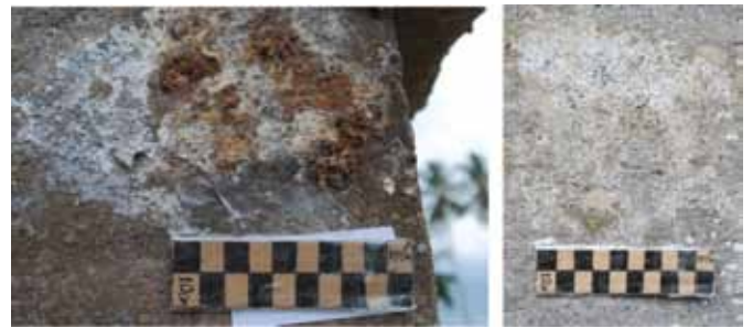
Foto 5. Penggaraman pada badan waruga yang meyebabkan terkelupas (kiri). Foto 6. Alveol pada permukaan badan waruga (kanan).
