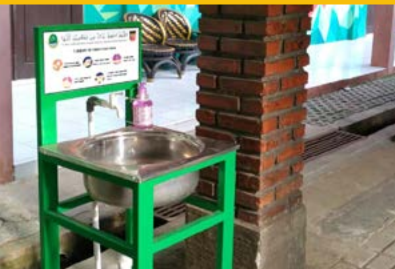
Sarana cuci tangan yang baik untuk mendukung PTM Terbatas
