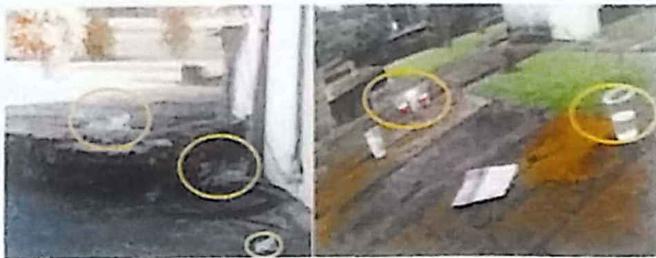
Sampah sisa konsumsi pengunjung yang dibiarkan berserakan di struktur benteng . (Dok. Kurata, 2019)
