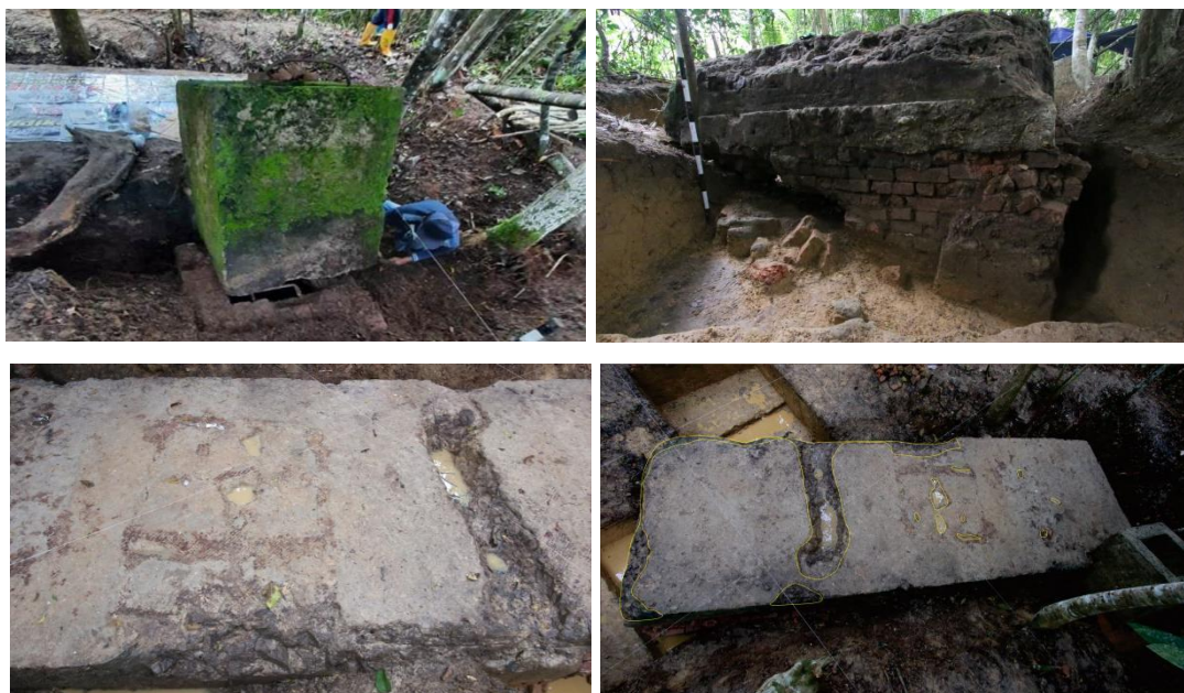
Foto 3 Kerusakan yang terjadi pada Bunker SM seperti miring, melesak, pecah, aus, berlubang, patah, retak, lapuk dan tumbuhnya mikroorganismenya seperti lumut (Dok. BPCb Kal-Tim, 2020).
