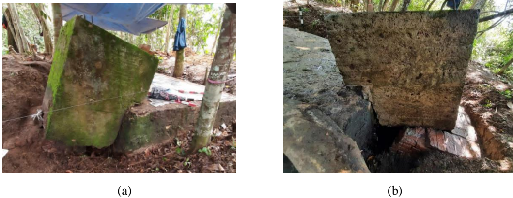
Foto 17 Struktur tangga sebelum pada sudut bunker yang ditumbuhi lumut (a) dan sesudah lumut dibersihkan (b)
