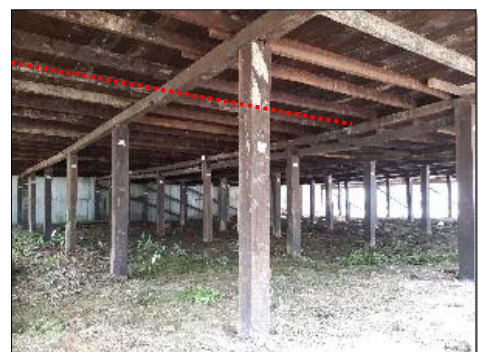
Foto 73. Gelagar Bagian Belakang (Dok. BPCB. Kalimantan Timur, 2018)
