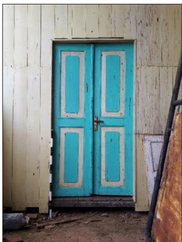
Foto 46. Pintu menuju basement dari luar bangunan (Dok. BPCB Kalimantan Timur, 2018)
