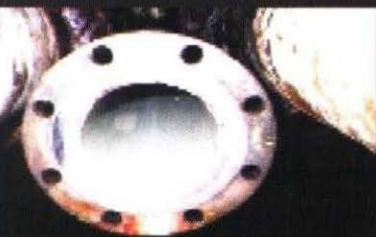
Besi yang Belum Terkorosi Pada Kondisi Netral.
