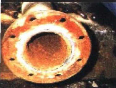
Korosi Pada Kondisi Asam Lebih Cepat Terjadi.
