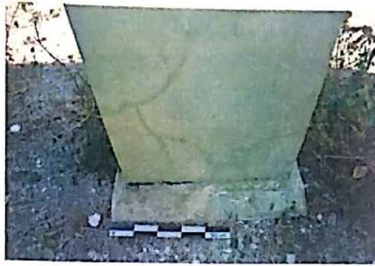
Foto 4. salah satu bagian permukaan bangunan yang sudah retak
