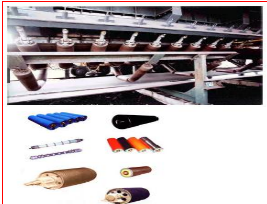
Gambar 75. Berbagai jenis idler dan pemasangan sebagai penyangga pada unit belt konveyor.
