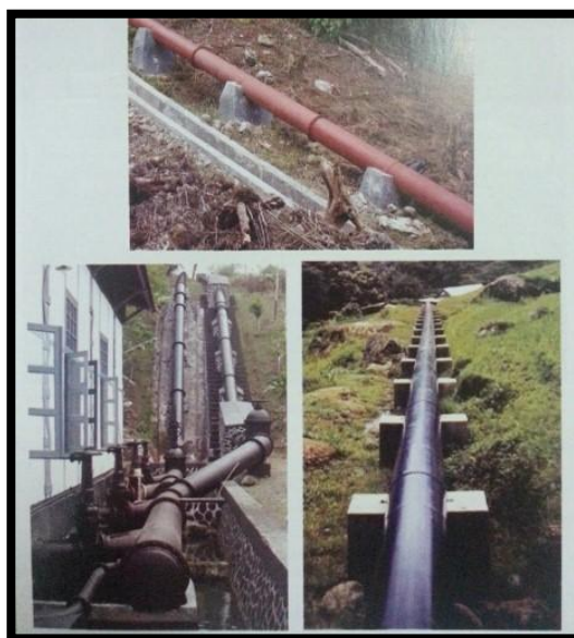
Gambar 9. Pipa Pesat atau Penstock
