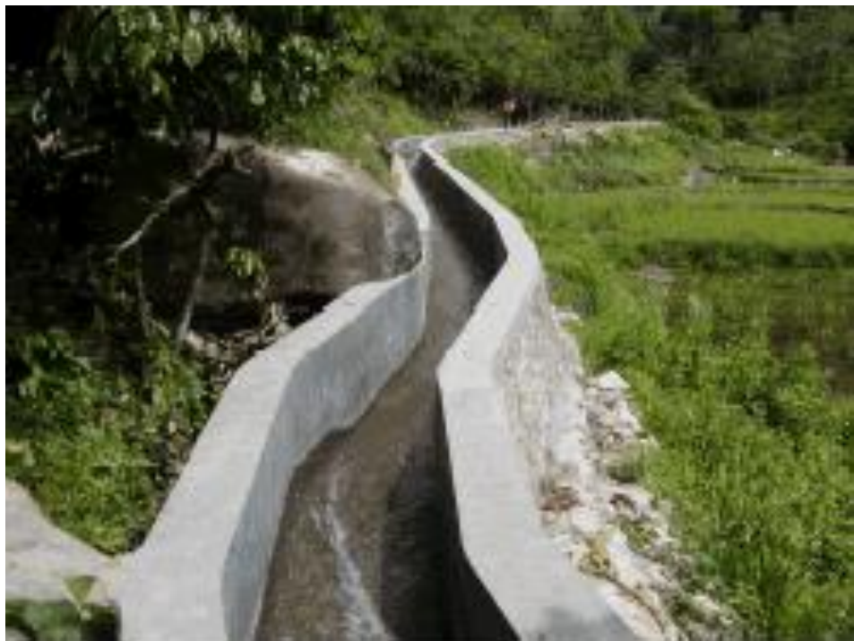
Gambar 7. Saluran Pembawa atau Headrace
